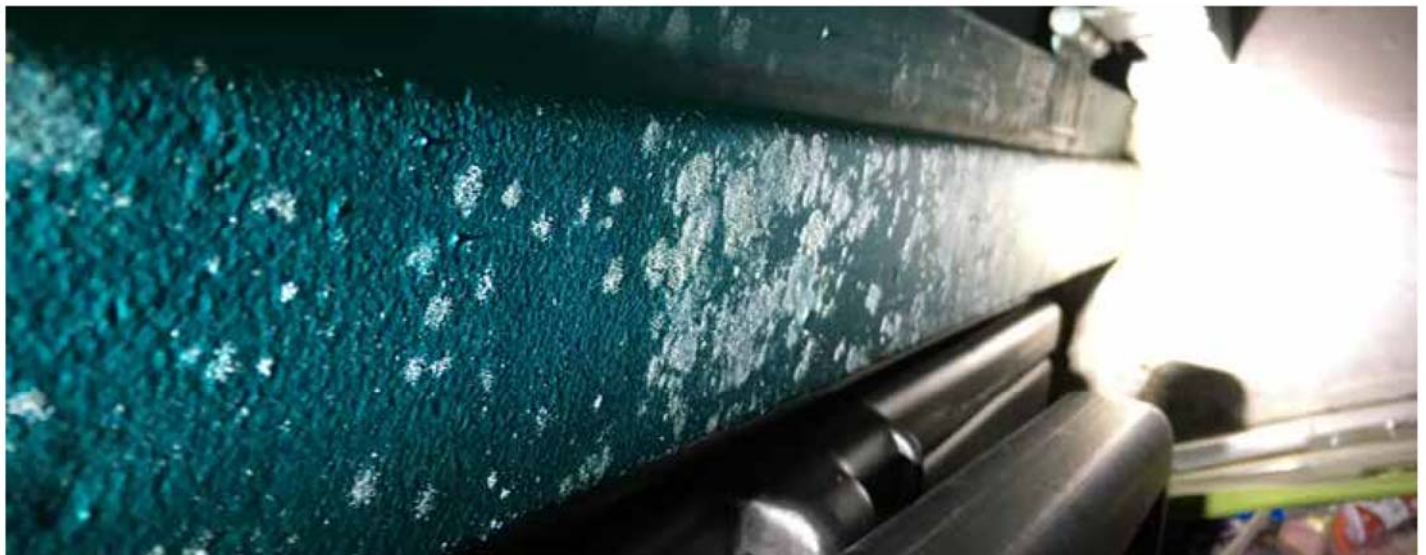
Mold on a metal door frame.
